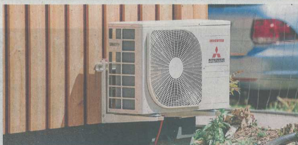
Split-Klimaanlagen kann man nicht selbst installieren.
